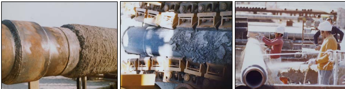
Bredero Price Beton am Yard und im Tensioner; Aufbringen GFK Coating am Pipeyard
